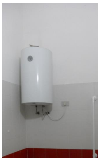
Figura 4.23 – Boiler elettrico – Bagno scuola elementare
