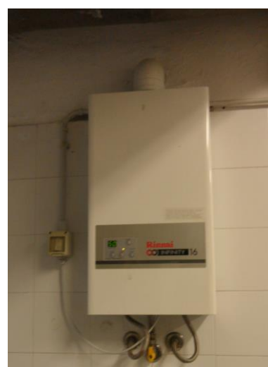
Figura 4.24 - Caldaia a metano - Cucina
