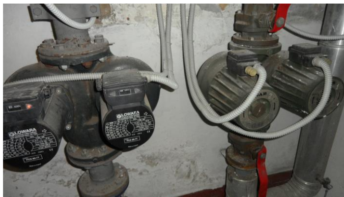
Figura 4.19 – Gruppi di pompaggio EG01-EG02
