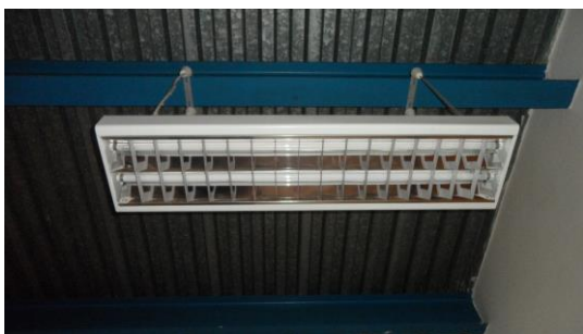
Figura 4.25 - Particolare dei corpi illuminanti ubicati nell’edificio- fluorescente 2X36W – Piano primo
