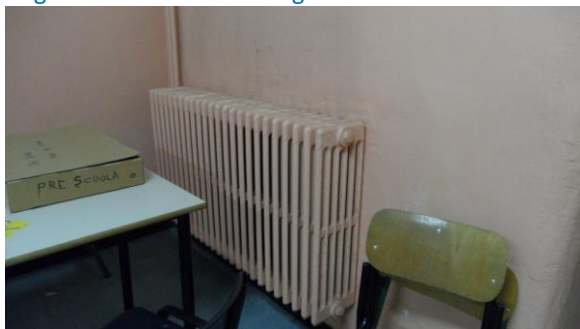
Figura 4.16 – Radiatori in ghisa – scuola elementare
