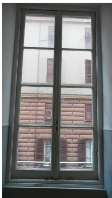
Figura 4.12 – Serramenti in alluminio e vetrocamera
