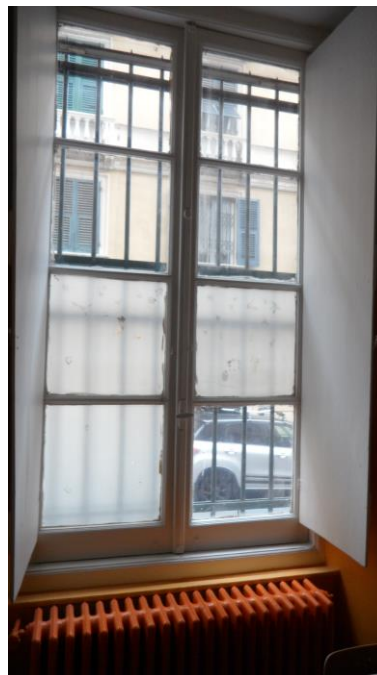
Figura 4.11 – Particolare – Serramenti in legno e vetro singolo
