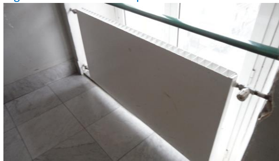
Figura 4.17 – Radiatori a piastra – scuola elementare
